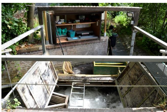
Figure 10: Vue du piège de montée en fonctionnement
