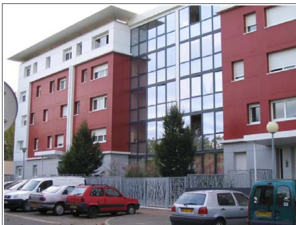
La réfection des façades en rouge et blanc ainsi que les baies vitrées ont fortement contribué à l'amélioration de l'esthétique de la résidence Photographie : CETE SO
