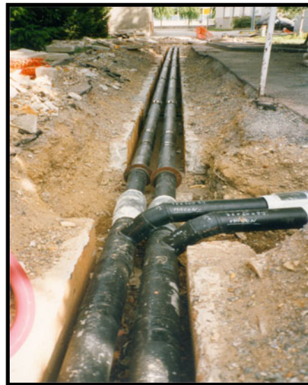
Photo 11 : Canalisation de chauffage urbain technique Wanner (source Compagnie Générale des Eaux)
