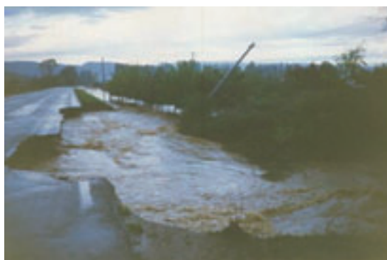
Photo n°3 : Affaissement sous la RD519 (Source : Subdivision de Roussillon-Beaurepaire)
