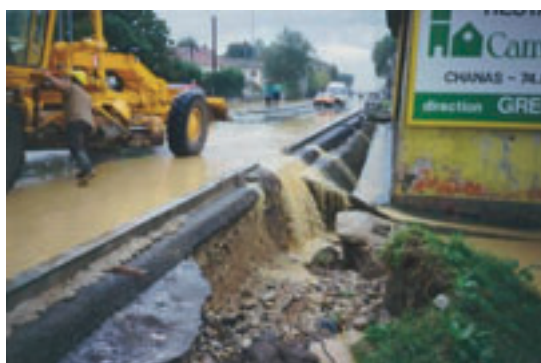
Photo n°4 : RN7 coupé à Salaise-sur-Sanne (Source : Subdivision de Roussillon-Beaurepaire)
