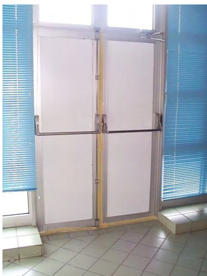
Figure 36 : Porte avant remplacement
