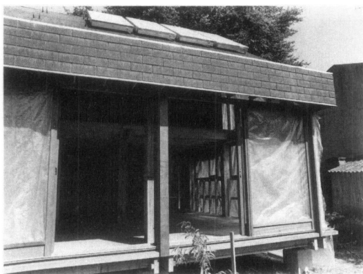
Maison solaire à ossature bois en cours de construction. En raison de ses qualités thermiques, le bois présente un intérêt tout particulier pour la conception des maisons susceptibles d'avoir recours au chauffage solaire.
